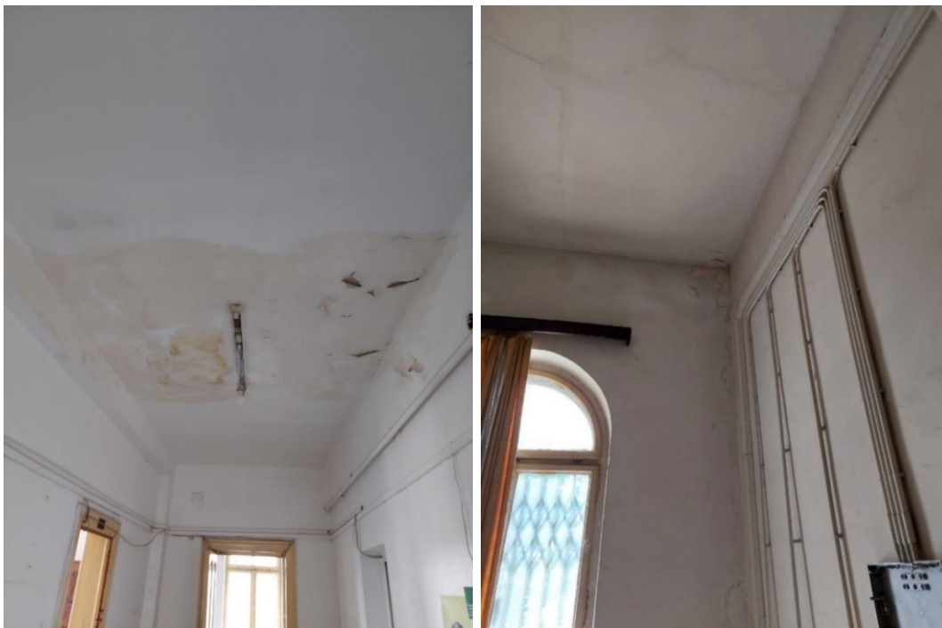
Figura 5. Fisuri și igrasie la plafoanele birourilor
