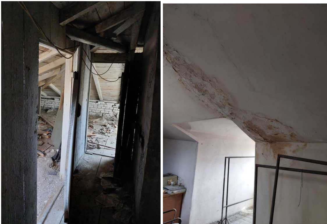
Figura 7. Deteriorări la nivelul mansardei
