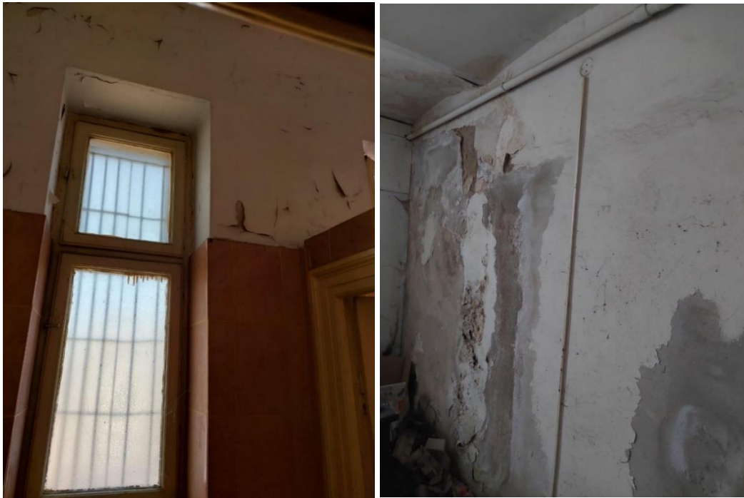
Figura 4. Fisuri și igrasie la pereții din birouri
