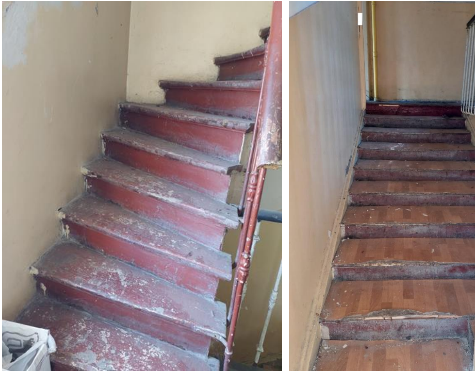
Figura 6. Scări deteriorate, la diferite niveluri ale clădirii
