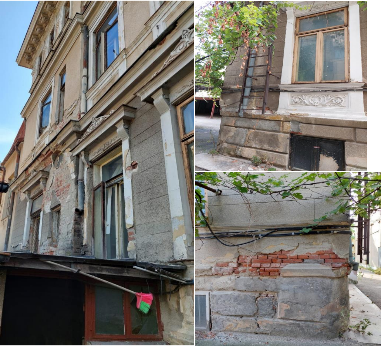
Figura 8. Deteriorări la nivelul fațadelor
